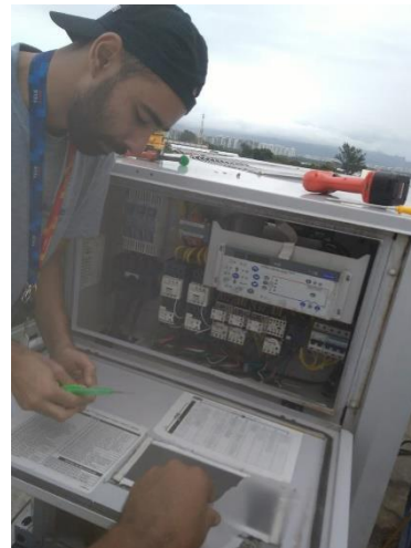
Foto 08: Teste de parâmetros elétricos e Startup do equipamento.
