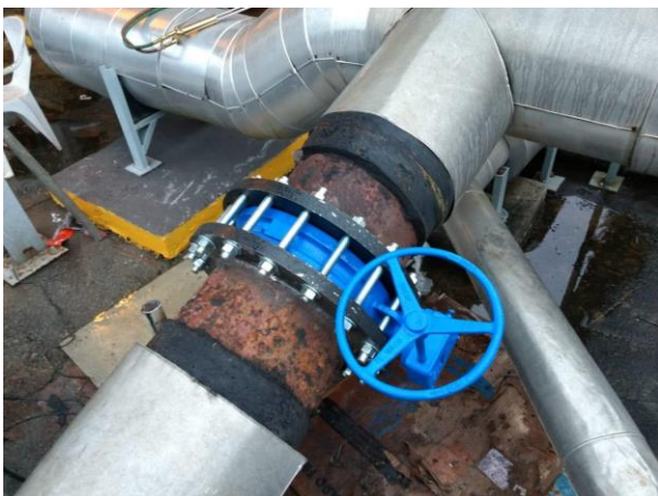
Foto 04: Válvula borboleta instalada na tubulação
