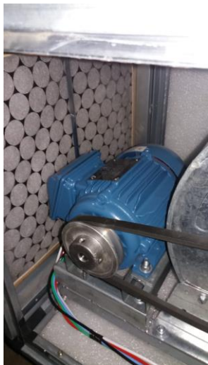
Foto 05: Verificação do estado e tensionamentos das correias
