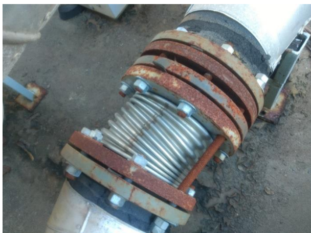
Foto 01: Tubulação e junta de expansão desalinhada
