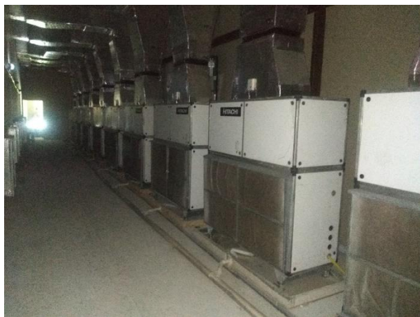
Foto 07: (Antes) Filtros de ar sujos e obstruídos
