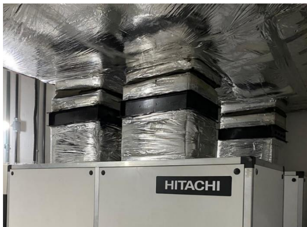
Foto 07: Interligação dos dutos de insuflamento das unidades evaporadoras
