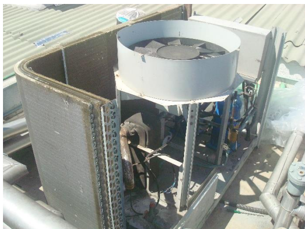
Foto 07: Chiller desmontado para o processo de revisão de componentes.
