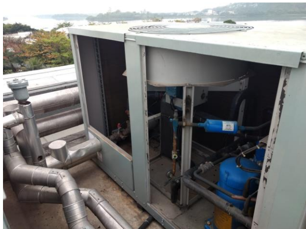
Foto 05: Chiller antes da revisão e manutenção.
