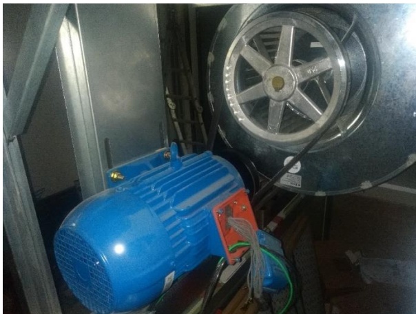
Foto 03: Interligação elétrica dos módulos ventiladores
