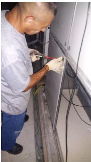
Foto 03: Verificação de componentes internos dos evaporadores
