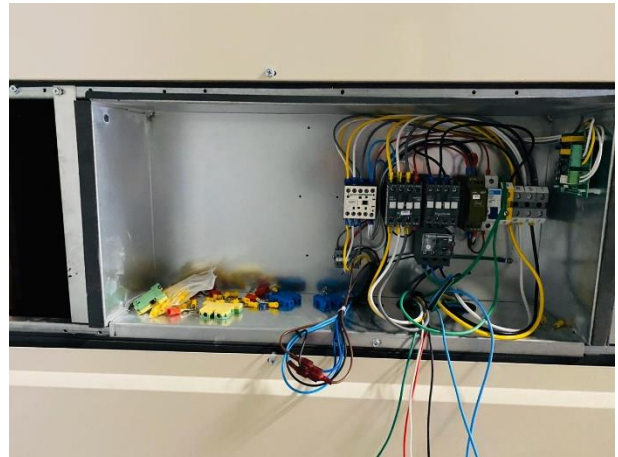
Foto 02: Interligação elétrica das unidades condensadoras
