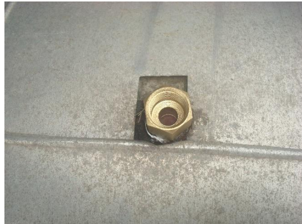
Foto 08: Poço de latão posicionado para medição de temperatura da água gelada
