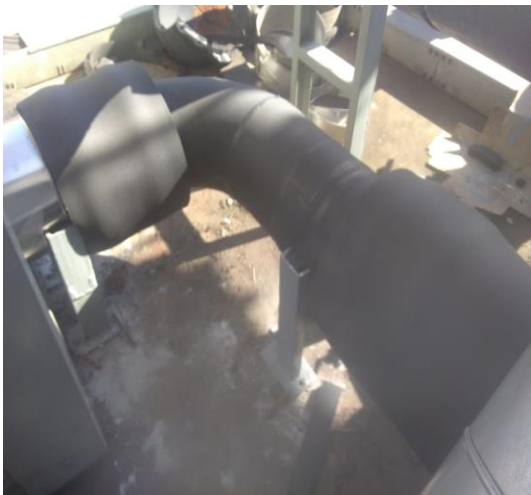
Foto 05: Isolamento térmico com borracha elastomérica Armaflex
